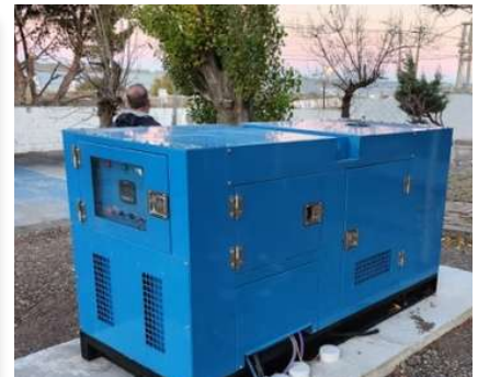
Grupo electrógeno de 40 kVA.
