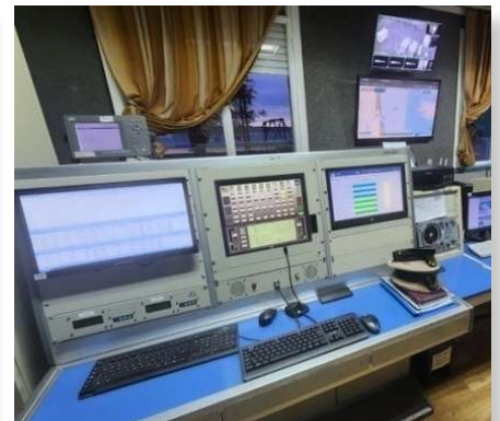
Sala de comunicaciones desde donde se operan los sistemas de comunicaciones.
