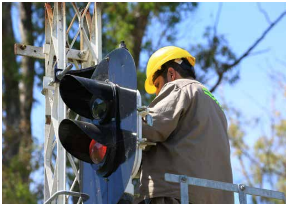
Señalamiento | Línea Roca
