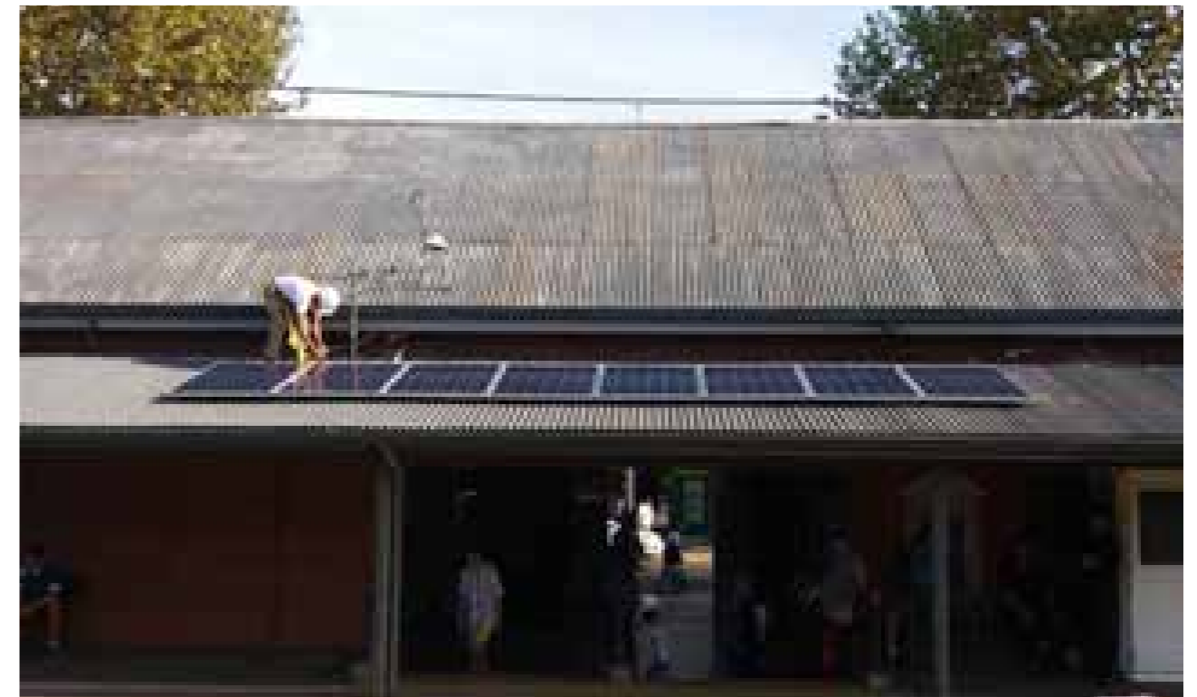
Paneles fotovoltaicos colocados en la estación San Martín, del ffcc Mitre - José León Suárez
