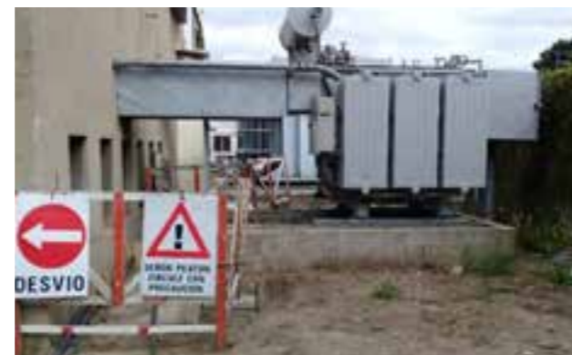
LP69/2015 Grupos Rectificadores Línea Sarmiento
