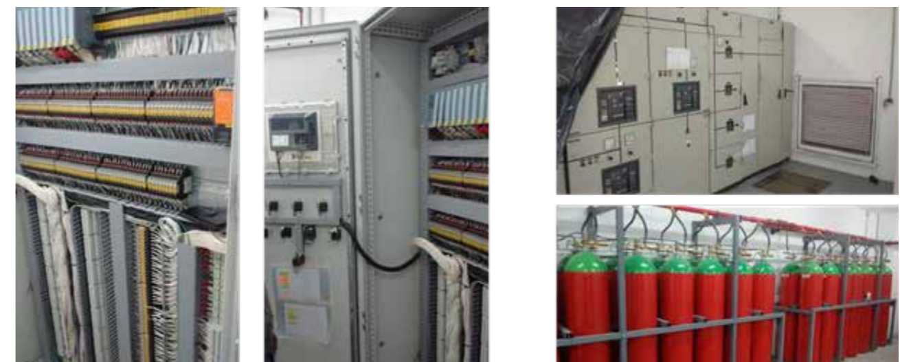
Nueva Subestación Retiro
