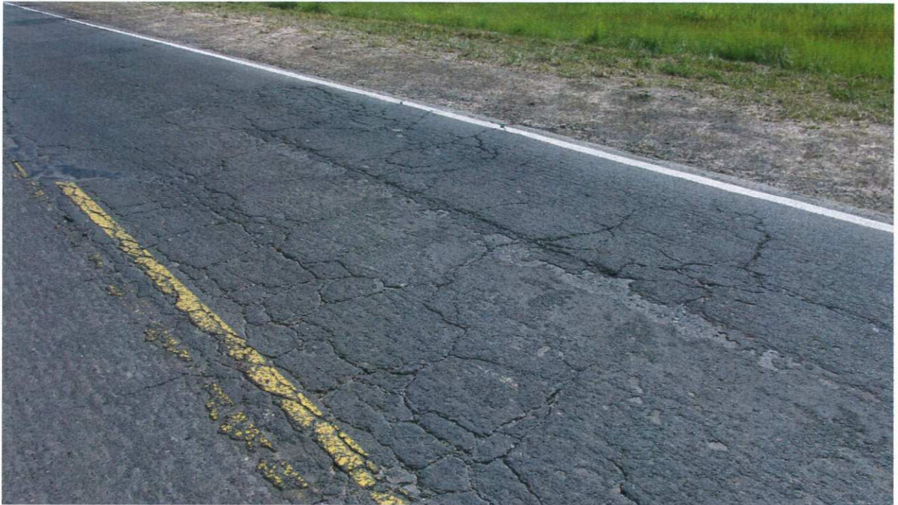
Sección S5 – Km. 1288,40. Calzada en estado deficiente.
