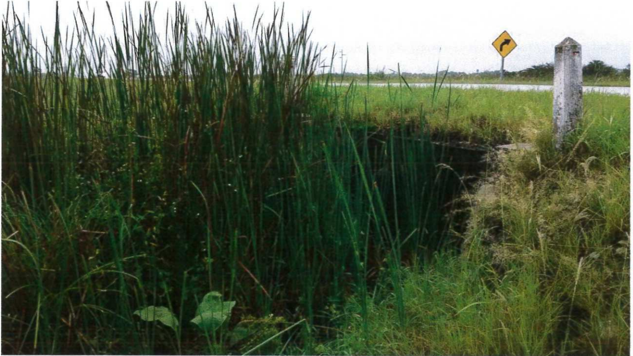
Sección S1. Vegetación en alcantarillas.
