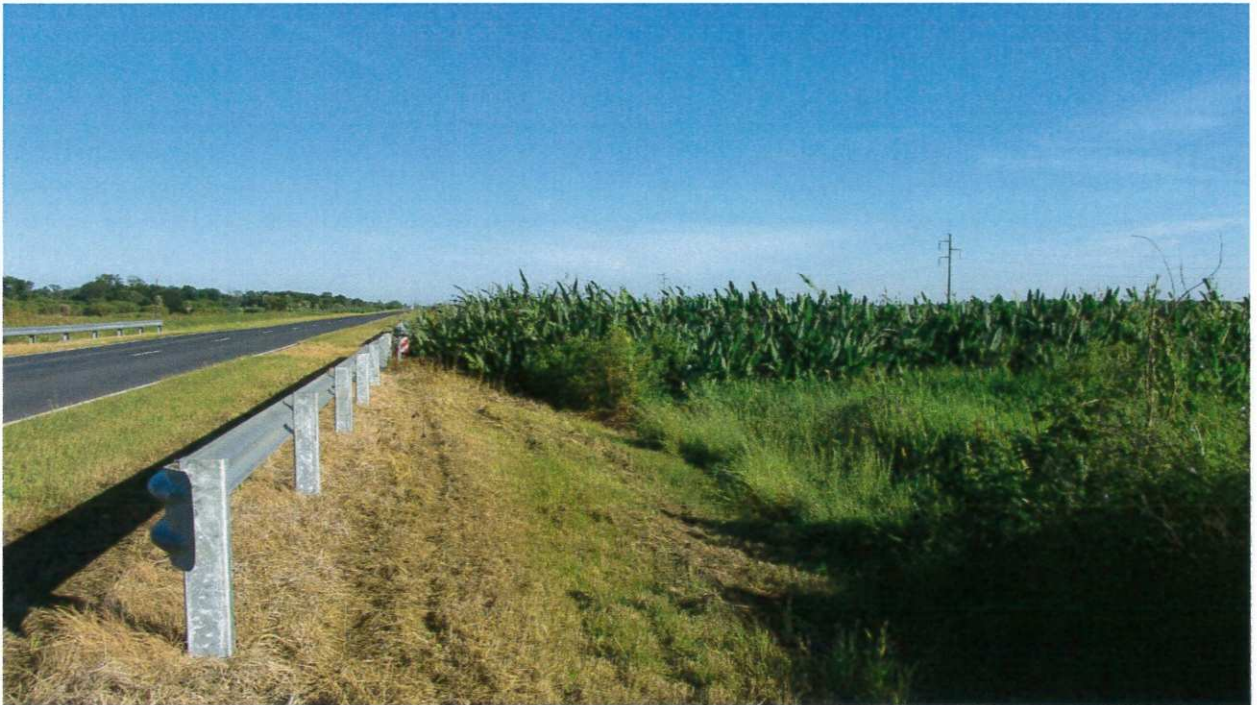
Sección S2. Vegetación en alcantarillas.
