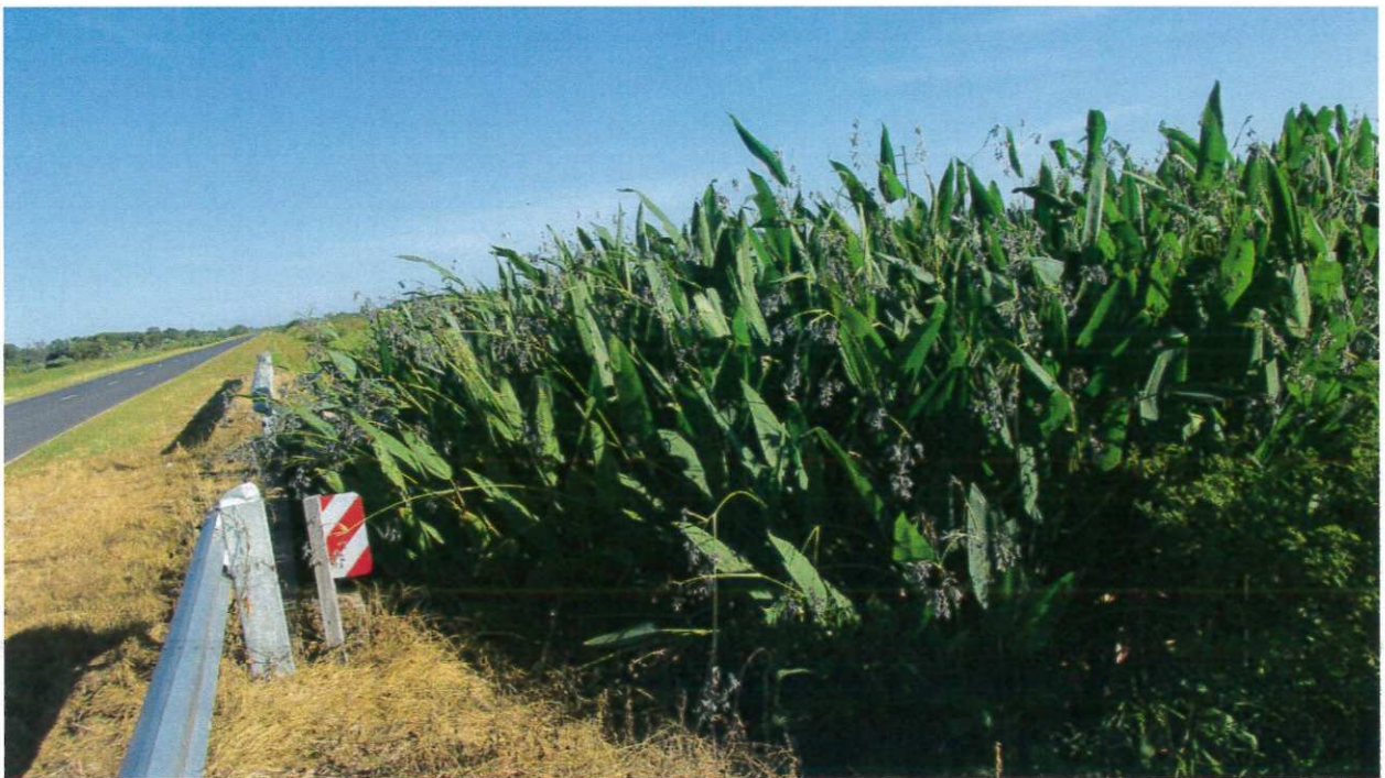
Sección S2. Vegetación en alcantarillas.
