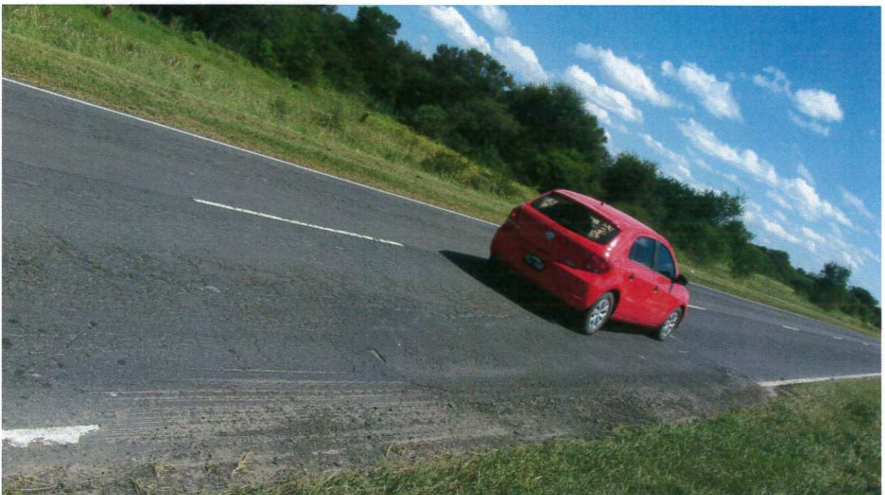
Sección S5. Calzada en estado deficiente.
