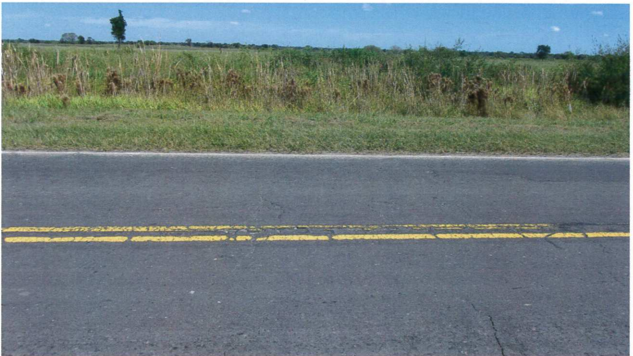
Sección S5. Km. 1295 – Km. 1301. Cota de banquina superior a la cota de calzada.
