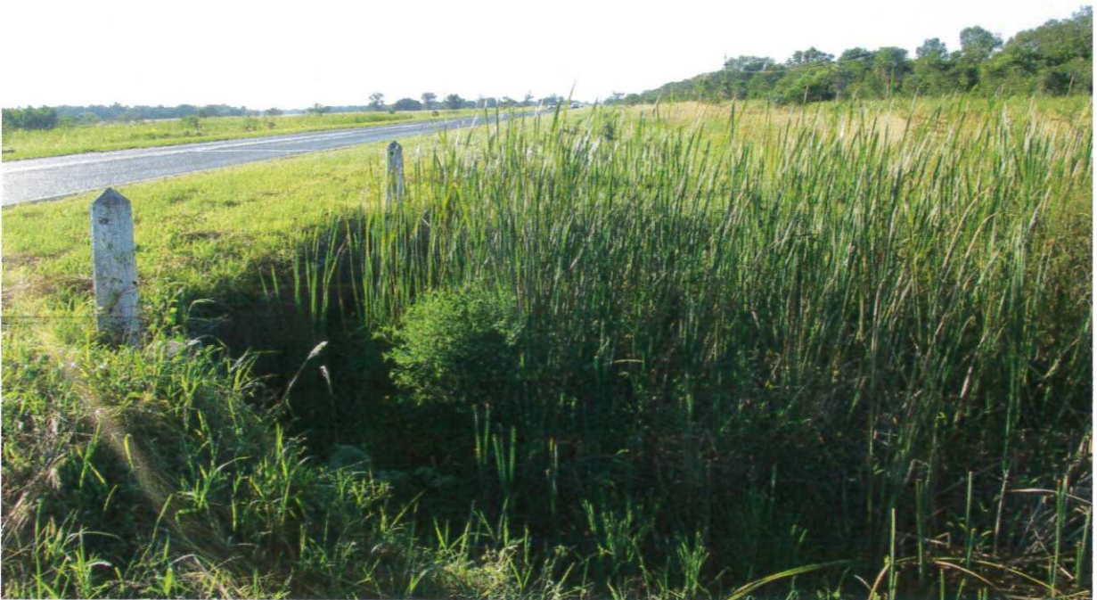
Sección S1. Vegetación en alcantarillas.
