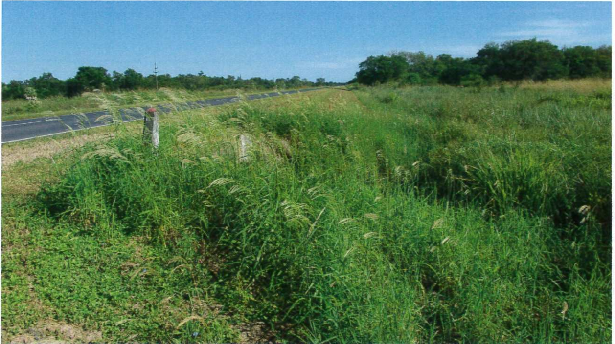
Sección S3 – Km. 1267. Alcantarillas sin señalizar con abundante vegetación.
