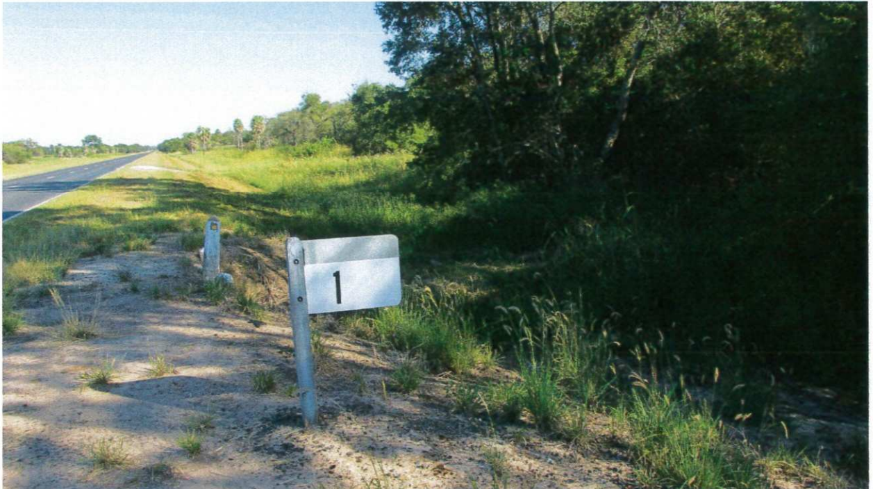
Sección S3. Mojón kilométrico en mal estado.
