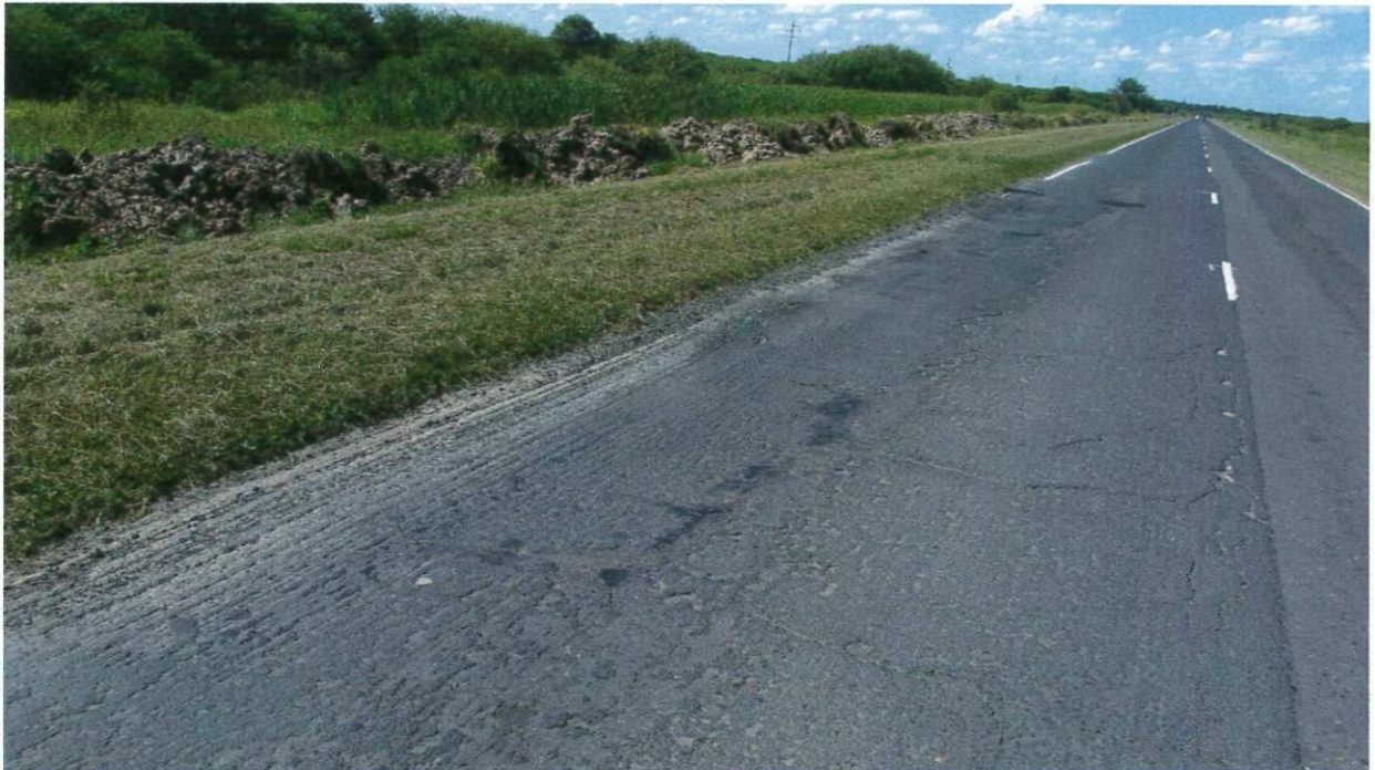
Sección S5. Deficiente estado de calzada y banquina más elevada que la calzada.
