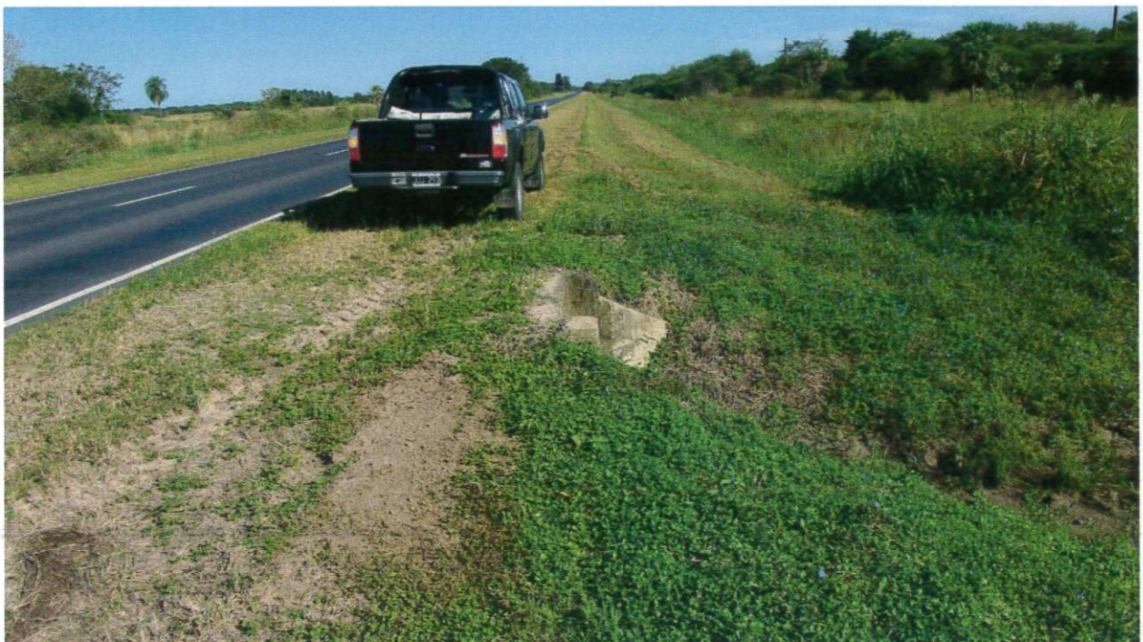
Sección S3. Alcantarilla sin señalizar, sumamente peligrosa.
