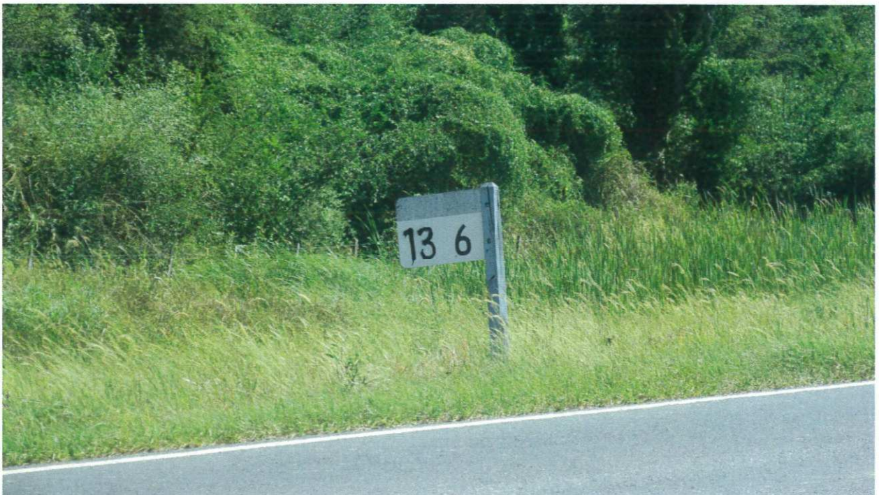
Sección S6. Mojón kilométrico en mal estado y pasto sin cortar en banquina.
