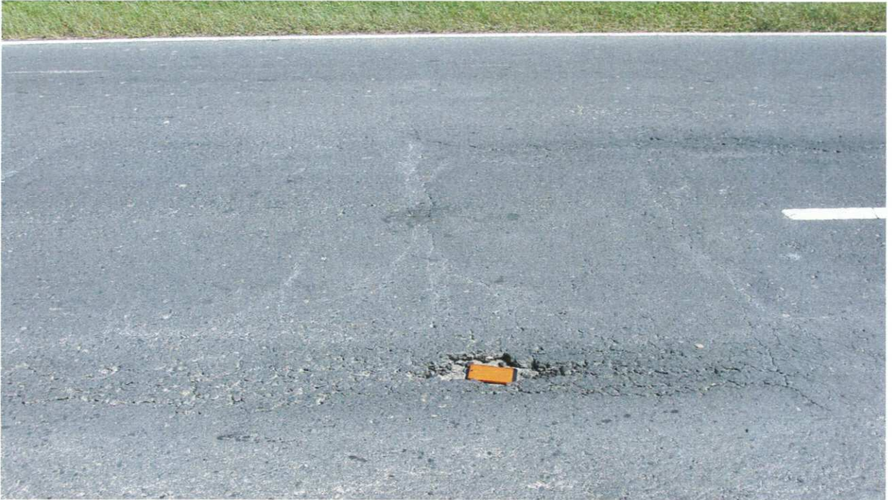
Sección S6. Calzada en estado deficiente.
