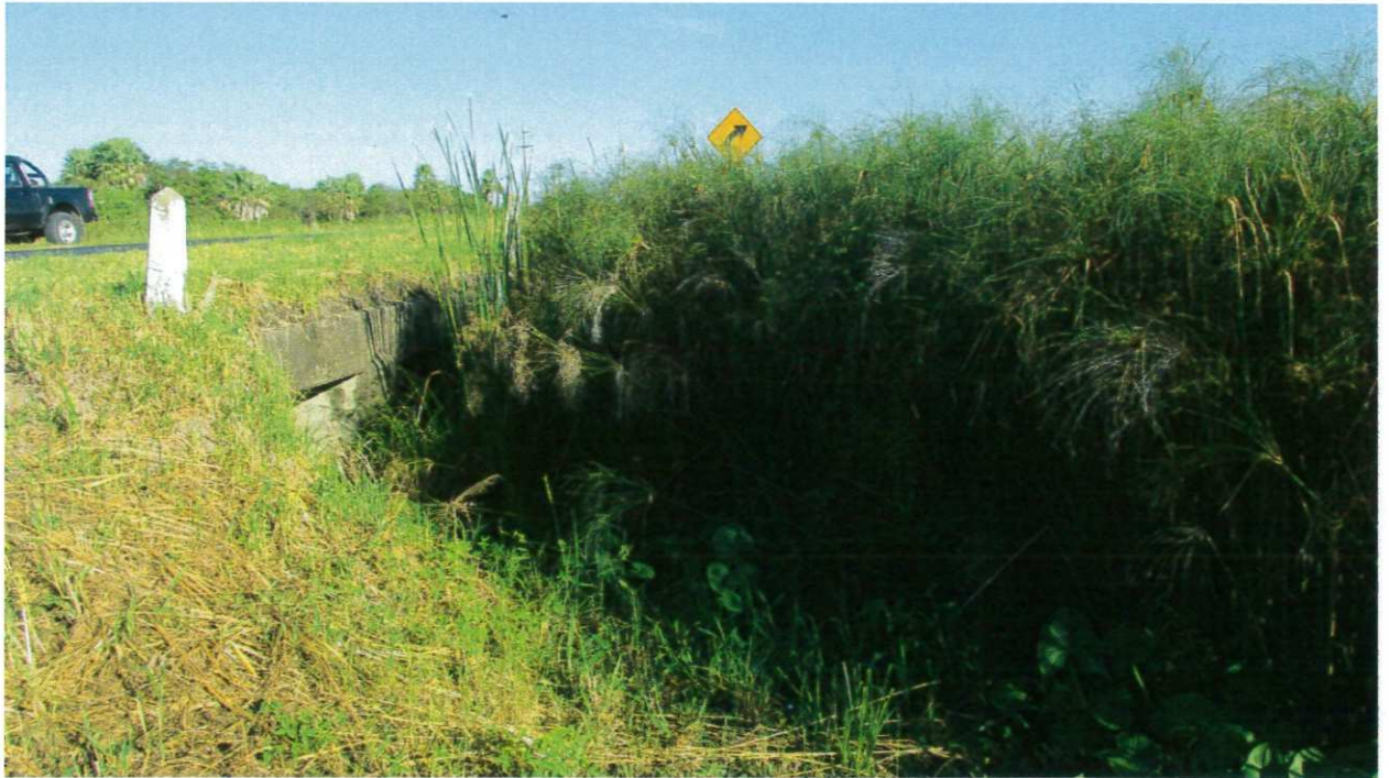
Sección S1. Vegetación en alcantarillas.
