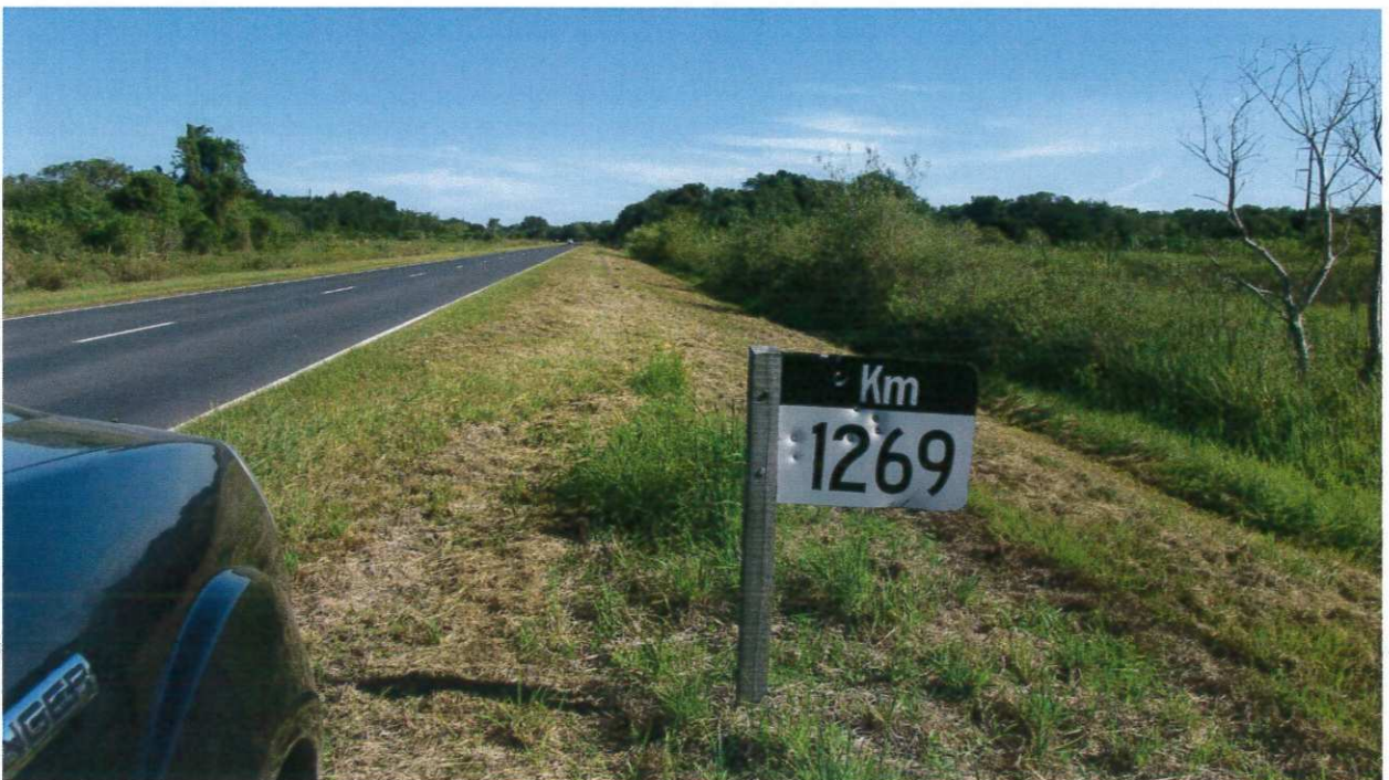
Sección S4 – Km. 1269. Vegetación sobre las cunetas.
